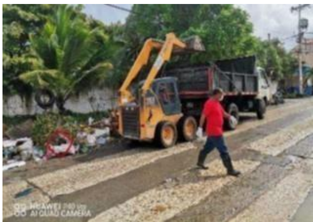
Recolección de material en punto crítico solomofles, sector de School House
