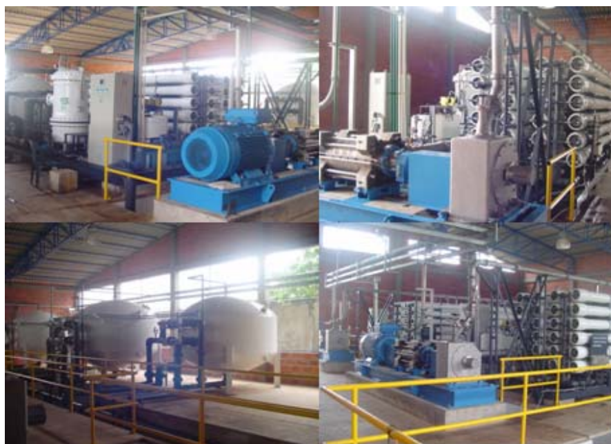
Panorámica Planta Desalinizadora
