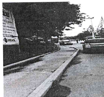
Falta nivelación de la base
